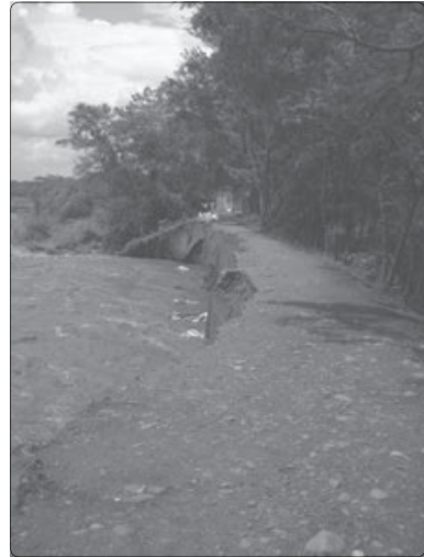
▲ Figura 2.46 Erosión activa de orillas caracterizadas por cortes verticales, derrumbes de bloques y caída de la vegetación.
